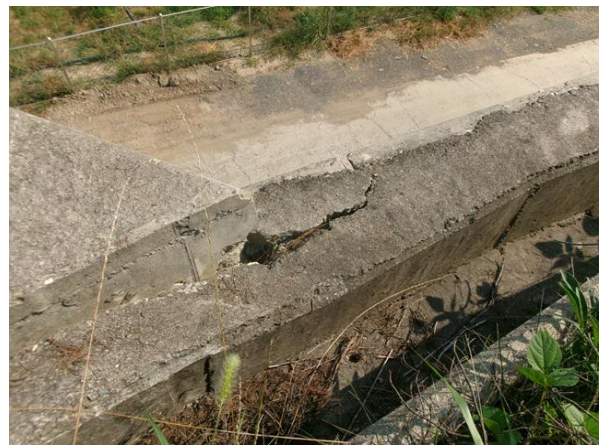
S10 상부 파손(0.2x0.3)
